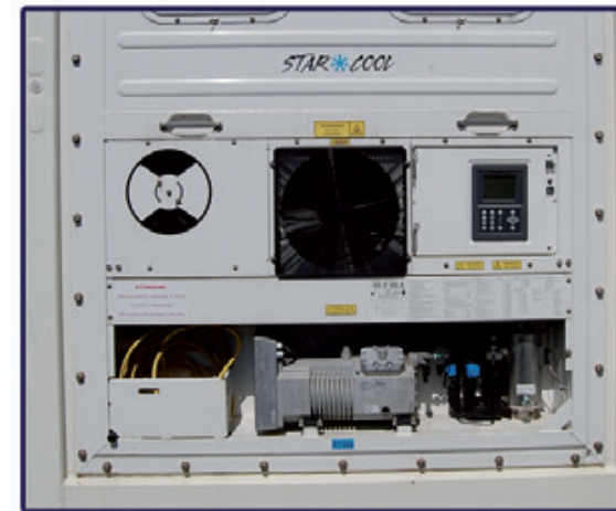
Impianto di raffreddamento
