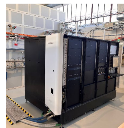
50 MW RF Source
