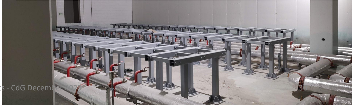
Zona CPU Sotto il pavimento
