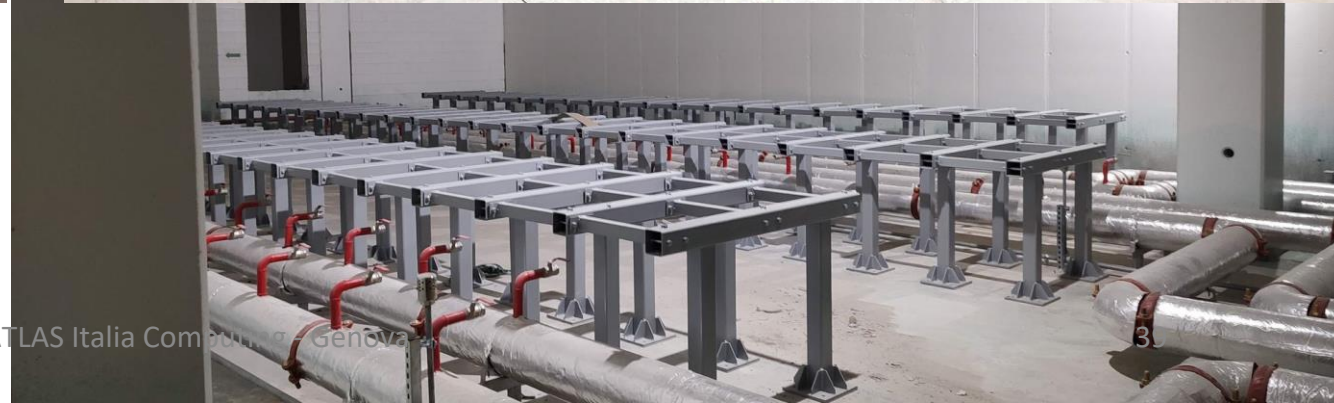
Zona CPU Sotto il pavimento
