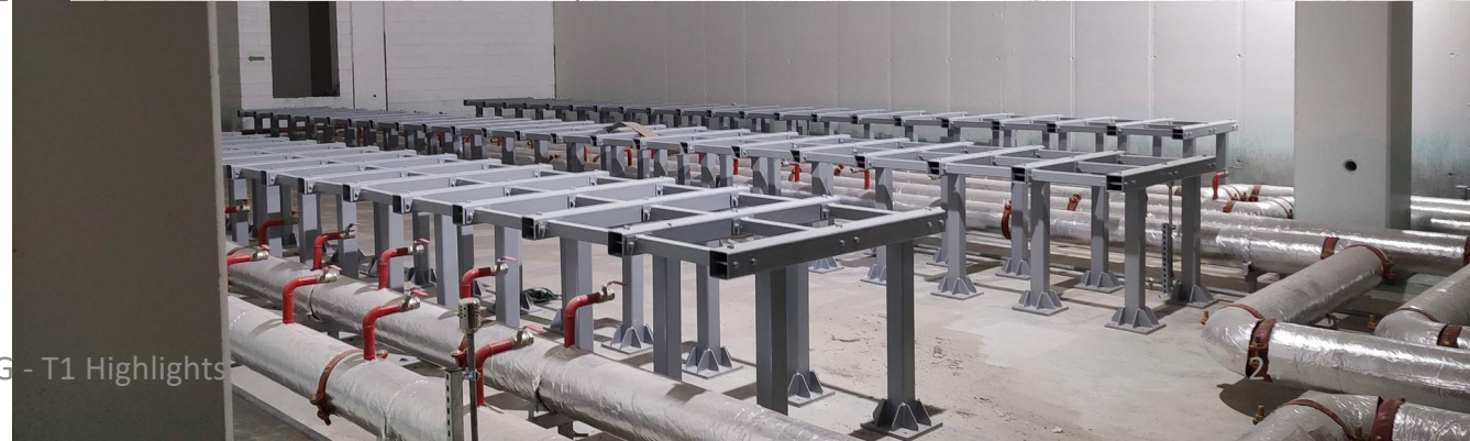
Zona CPU Sotto il pavimento
