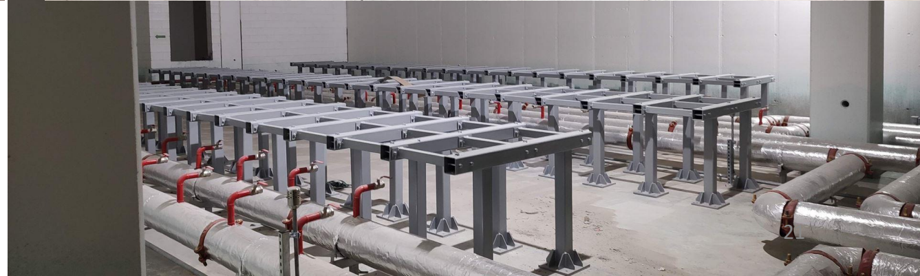
Zona CPU Sotto il pavimento
