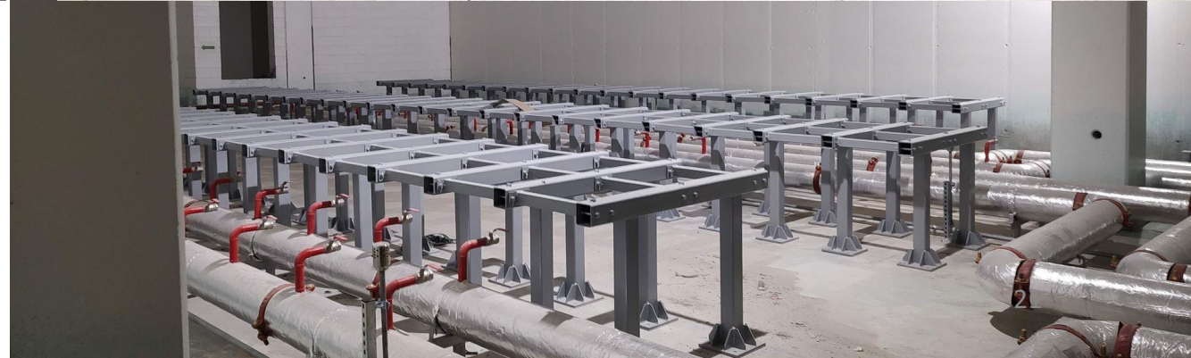
Zona CPU Sotto il pavimento
