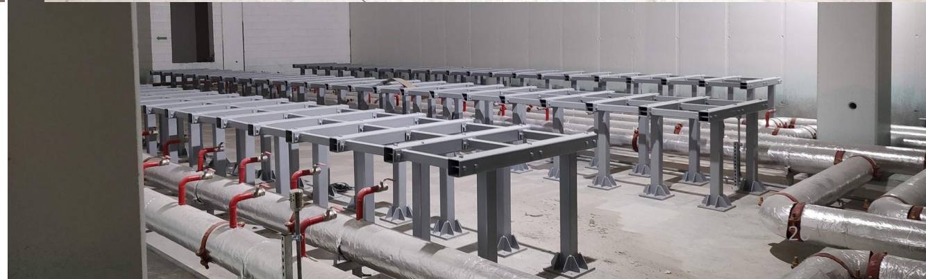
Zona CPU Sotto il pavimento
