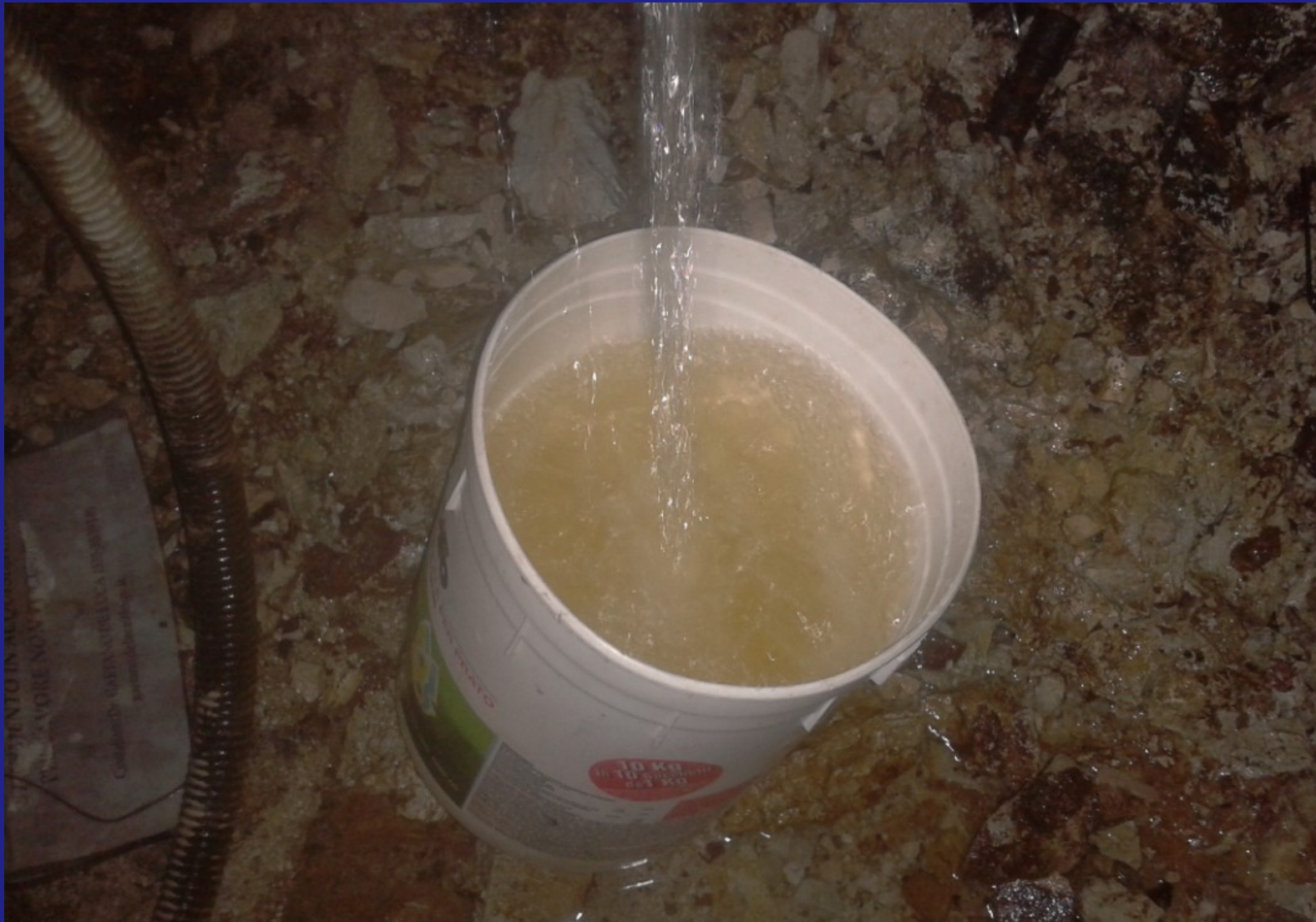
Sopralluogo nella camera dei drenaggi nella mattinata del 13 ottobre 2016 particolare della colorazione dell'acqua prelevata dal sondaggio S13
