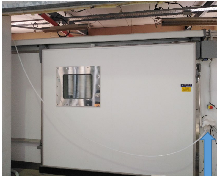
Nuovo Ingresso Aria Secca
